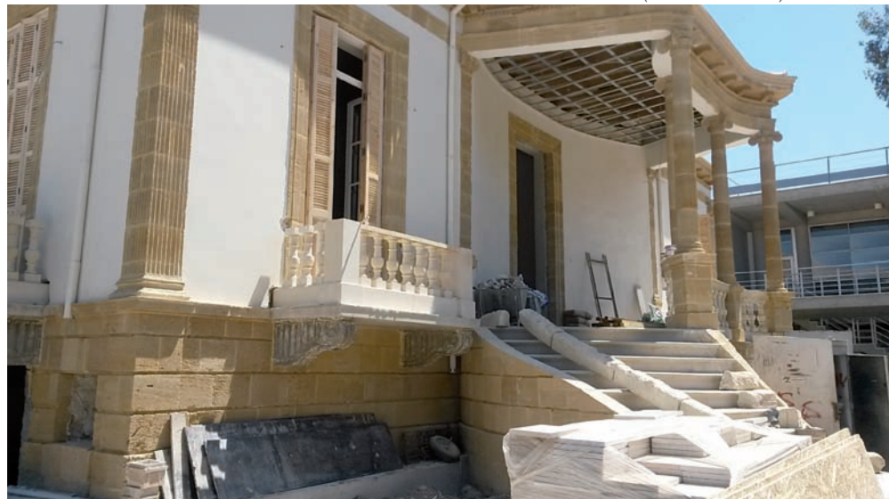
ΕΡΓΑΣΙΕΣ ΑΠΟΚΑΤΑΣΤΑΣΗΣ ΤΟΥ ΚΛΙΜΑΚΟΣΤΑΣΙΟΥ ΚΑΙ ΤΟΥ ΠΡΟΣΤΕΓΑΣΜΑΤΟΣ ΤΗΣ ΚΕΝΤΡΙΚΗΣ ΕΙΣΟΔΟΥ. (ΑΡΧΕΙΟ Ε. ΣΟΦΙΑΝΟΥ)
